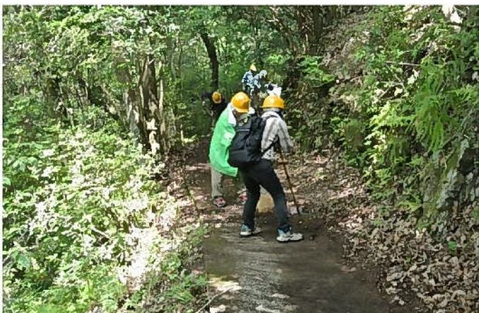
登山路に落ち葉・土砂が延々と堆積 撤去中
