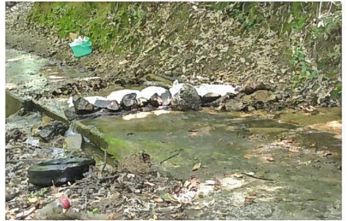
溢れる水 応急処置として路に土嚢を並べた
