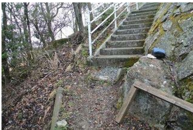
灰ヶ峰 山頂展望台の階段（整備前）
