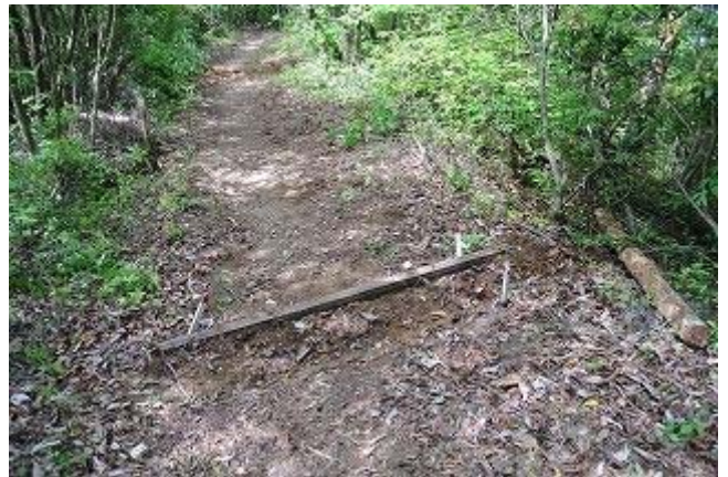
選挙の時の廃材垂木 4 本をネジクギで留め横断溝を新設
