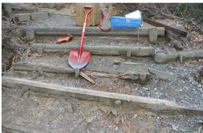
中国自然歩道 大庭山 腐りかけた階段
