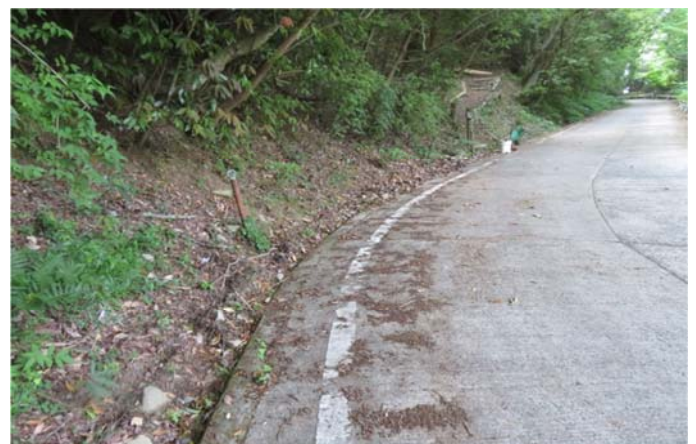
整備作業前 すっかり埋まった側溝
