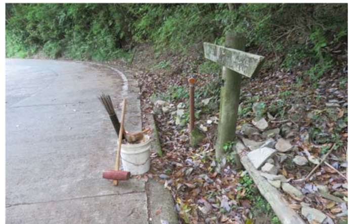
整備前の埋まってしまった側溝
