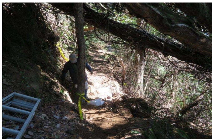
陥没を土嚢・岩・土砂で埋め戻す
