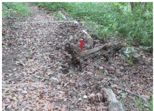
古い木で路肩を固めていたが破壊されていた
