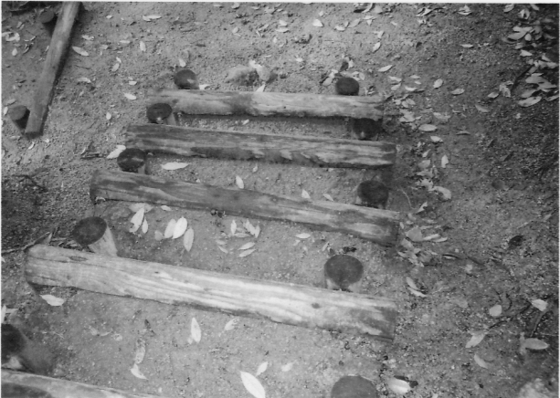
階段部の土砂が無くなっている
