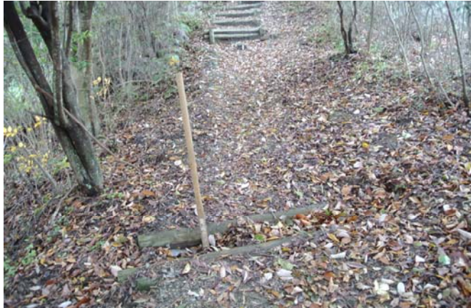
補修前の「上山」の手前
