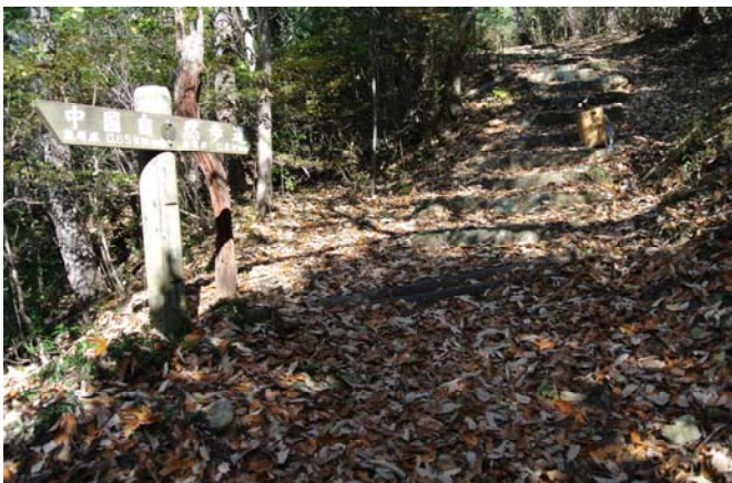
落葉・土砂に埋まった横断溝(整備前)
