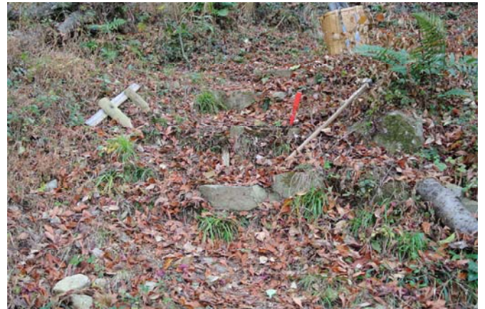
腐りかかった階段(取替え・整備前)
