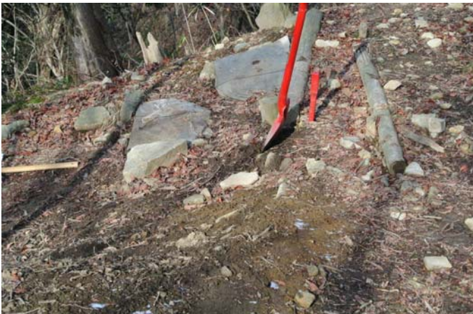
土砂に埋まった横断溝
