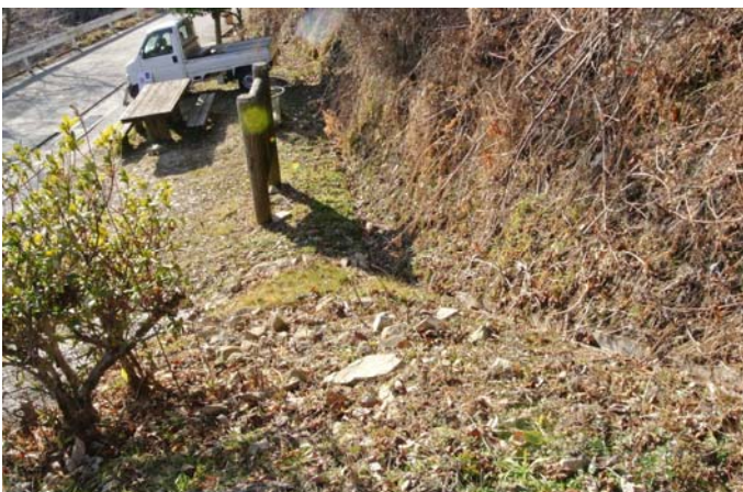
土砂に埋まった側溝
