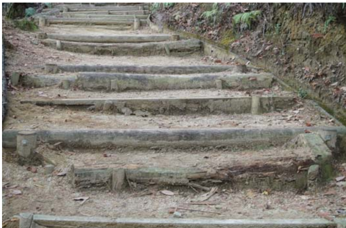
腐蝕した階段
