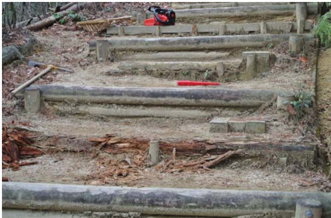
腐食著しい階段
