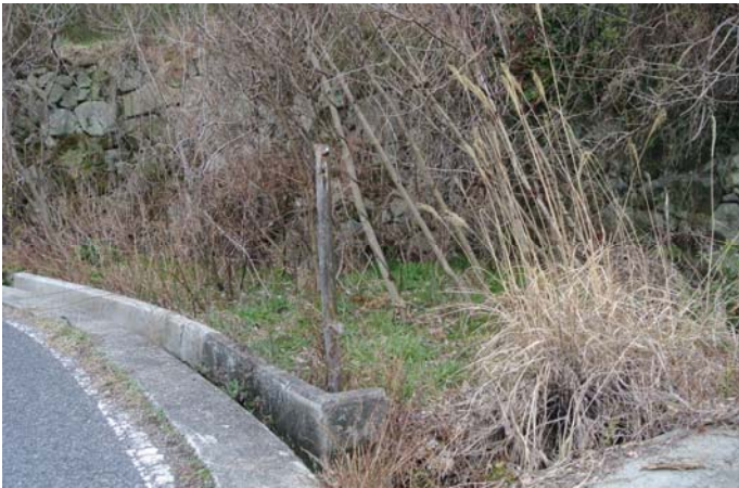
道標の支柱への取り付け部が腐蝕し脱落
