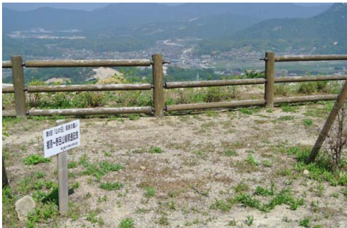
(公園造り広場) 木柵の部材が割れて脱落
