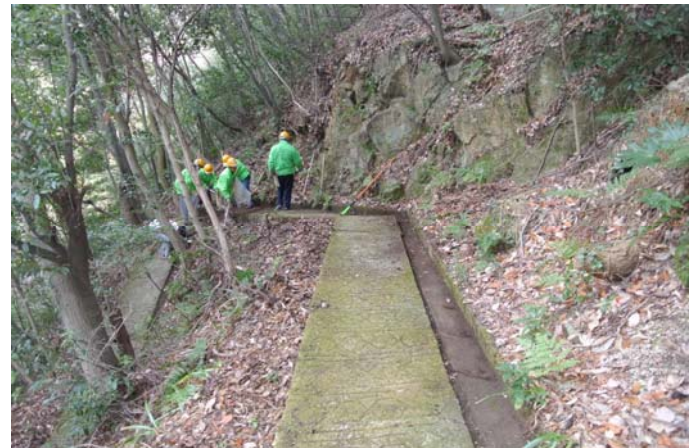
側溝を埋めた落ち葉除去後の参道
