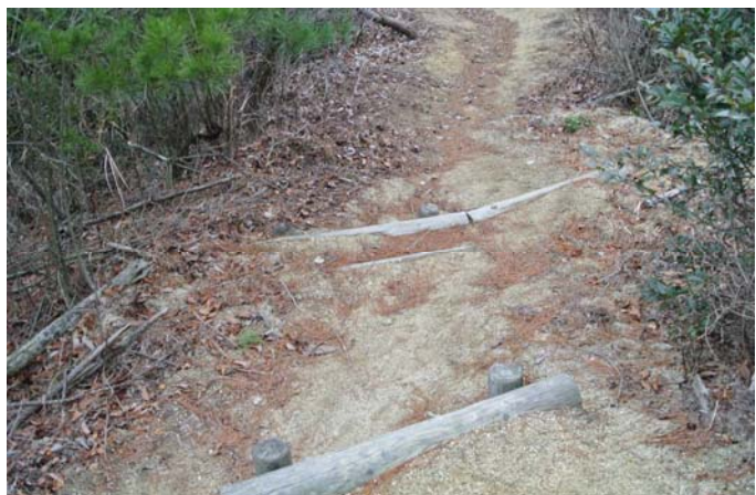
土砂で埋まった横断溝
