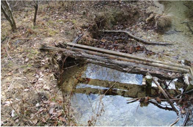
橋の袂が水でえぐられて支えを失った橋
