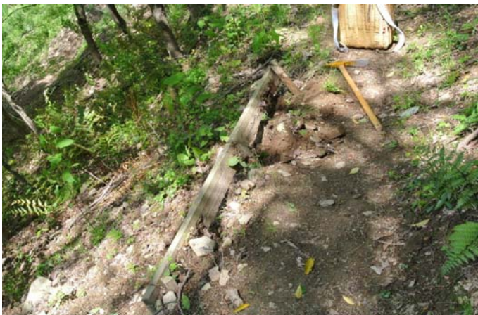
崩れかけた路肩
