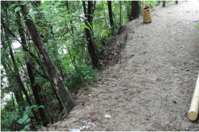
崩れかけている路肩(補強前)
