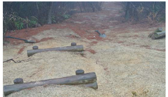
せっかくの階段が浮き上がり階段の用を成さなくなったので これらを抜いて段差の大きいところに階段増設
