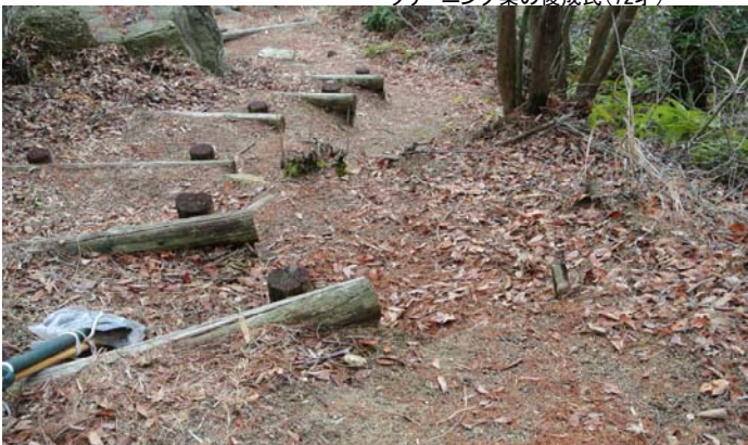
崩れかけている急な階段
