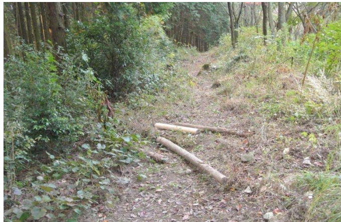
古くなった横断溝 持参の資材 工事前
