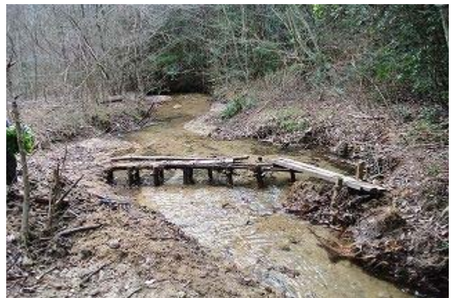
左の橋の手入れ後 川底を掘り、古木・落ち葉を撤去後 (整備後) 奮闘2人で2時間 28.1.7
