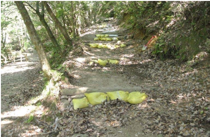
崖からの水が流れて路を削ってしまったので土嚢を並べて土砂の流失を抑える
