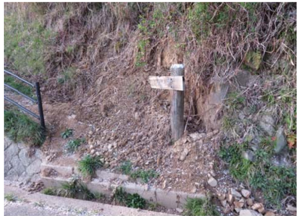
猪が法面を崩落させたので3時間 奮闘
