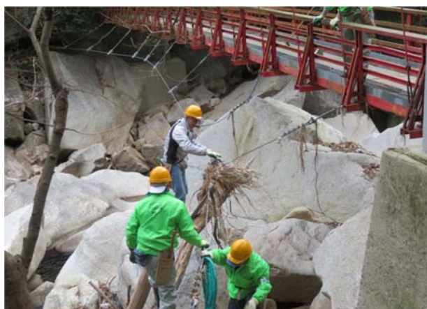
吊り橋のワイヤーに巻きついた流木撤去中
