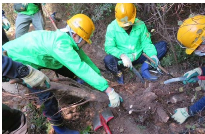
側溝に生えた木の根っこ撤去中
