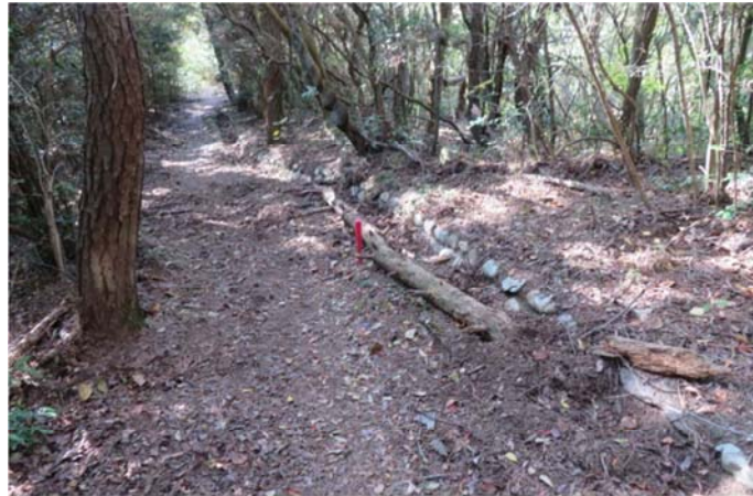
土砂 枯れ木で埋まったままの側溝(整備前)
