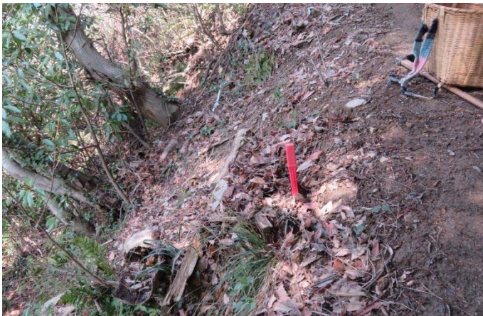
路肩の弱いところ補強前
