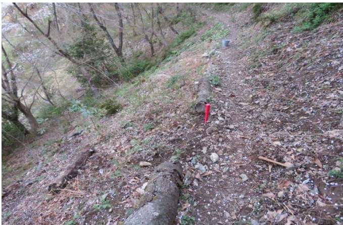
路肩の資材が転落 補修前
