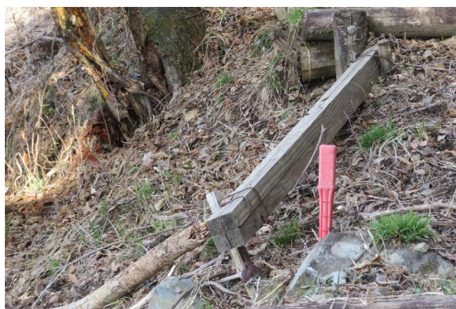
浮いたままの路肩（手入れ前）
