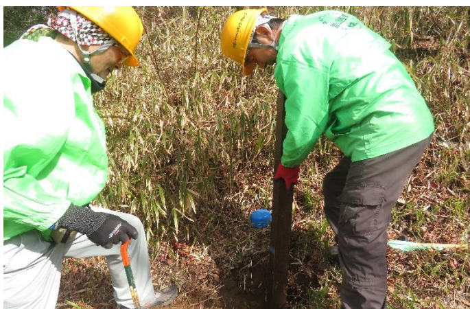
A チームの作業の様子④ 支柱を設置して周囲を埋めています。
