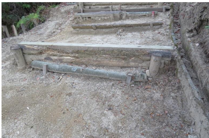
大庭山の荒れた登山道の一部。 足で踏む部分の木材が壊れていますね。
