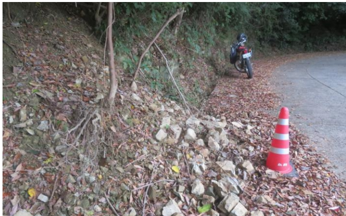
先ほどとは違う地点の土砂崩れ現場。道路の片側が通行できない状態でした。
