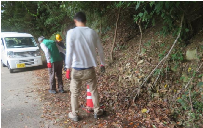
大きな石を粗方撤去したので、ブローで軽く落ち葉を飛ばしてこの地点は2車線とも通行出来るようになりました。
